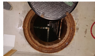
ビルの汚水槽
