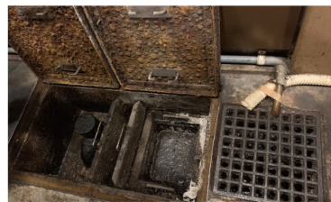
厨房の排水溝
